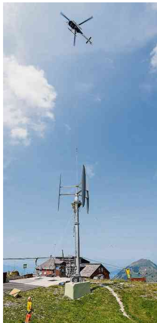
Spektakulär: Per Helikopter wird die neue Windturbine am Berggasthaus Haldigrat montiert. Bild: pd
